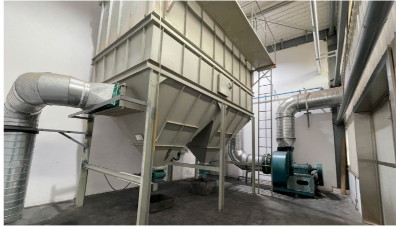
▲ 株钻公司废水处理设施
